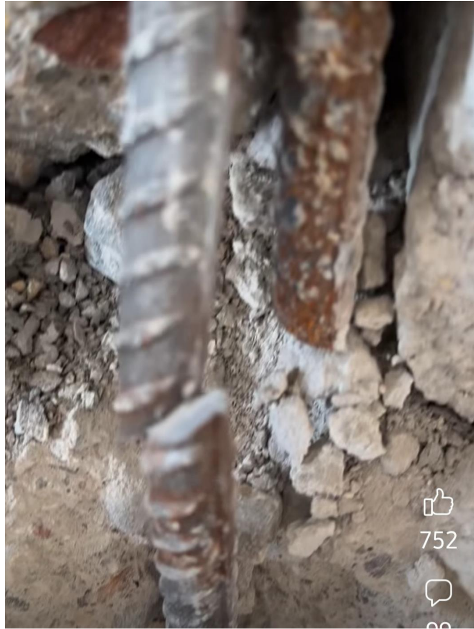
6 Şubat Depremleri sonrası korozyon nedeniyle gevrek kırılma gösteren bir donatı
