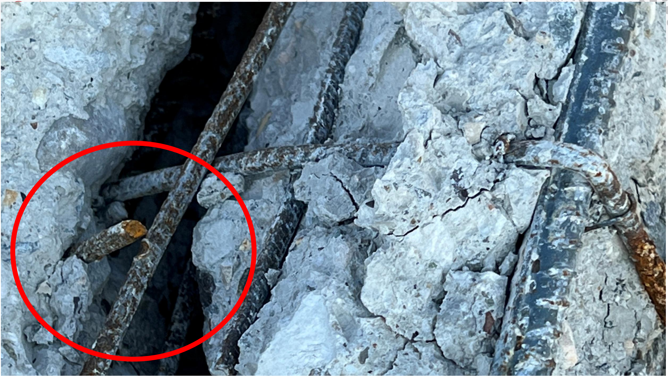
6 Şubat Depremleri sonrası korozyon nedeniyle gevrek kırılma gösteren bir donatı
