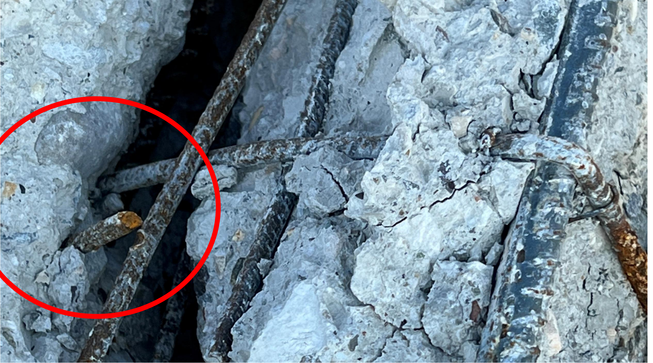
6 Şubat Depremleri sonrası korozyon nedeniyle gevrek kırılma gösteren bir donatı
