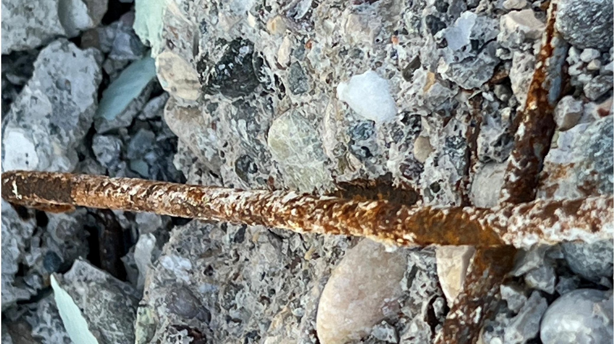
6 Şubat Depremleri sonrası hasarlı bir yapıdaki korozyona uğramış donatı
